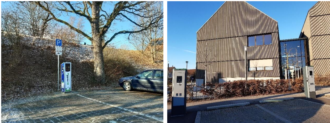
Abbildung 33: E-Ladestationen am Bahnhof und am Rathaus
